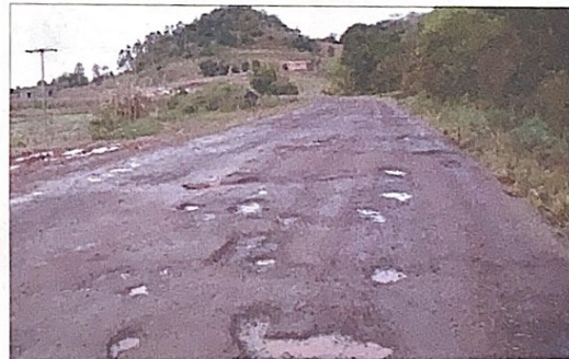
Trecho asfaltado da RS-422 está se deteriorando sem manutenção
